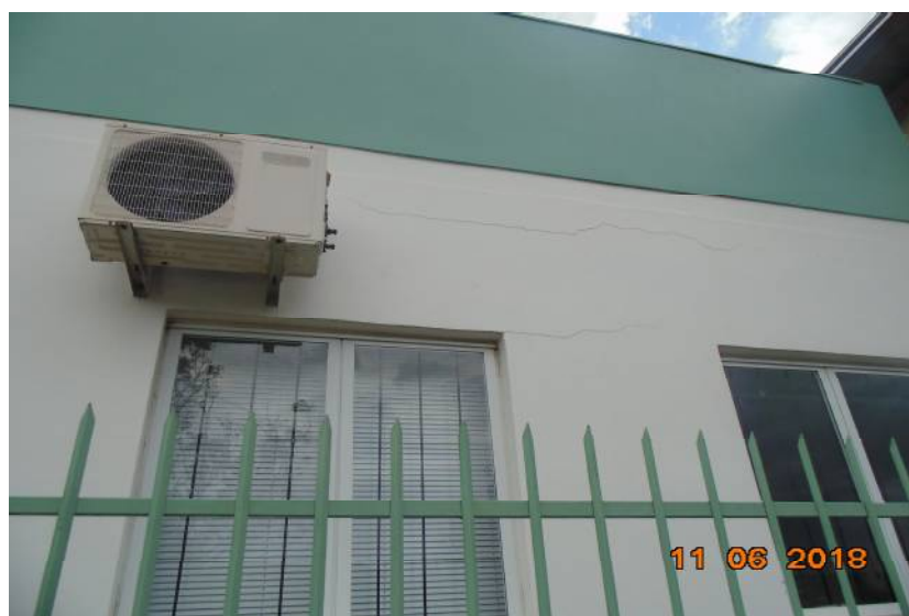
Figura 2: Corrigir fissuras na fachada principal.
