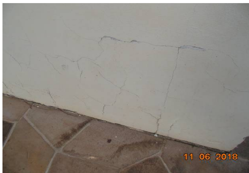
Figura 3: Corrigir fissuras externas.
