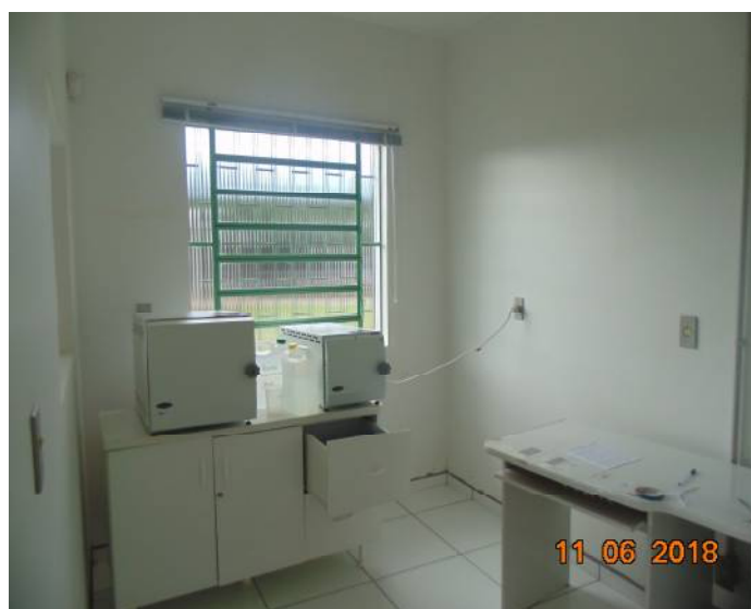
Figura 4: Corrigir patologia nos locais necessários.
