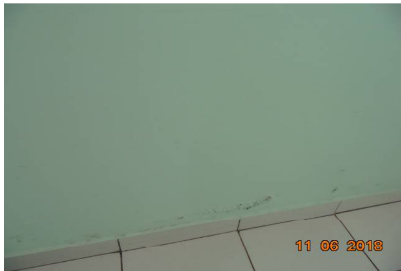
Figura 5: Arrumar patologias da superficie – retirar reboco, e refazer. Aplicar massa corrida e posteriormente as pinturas.
